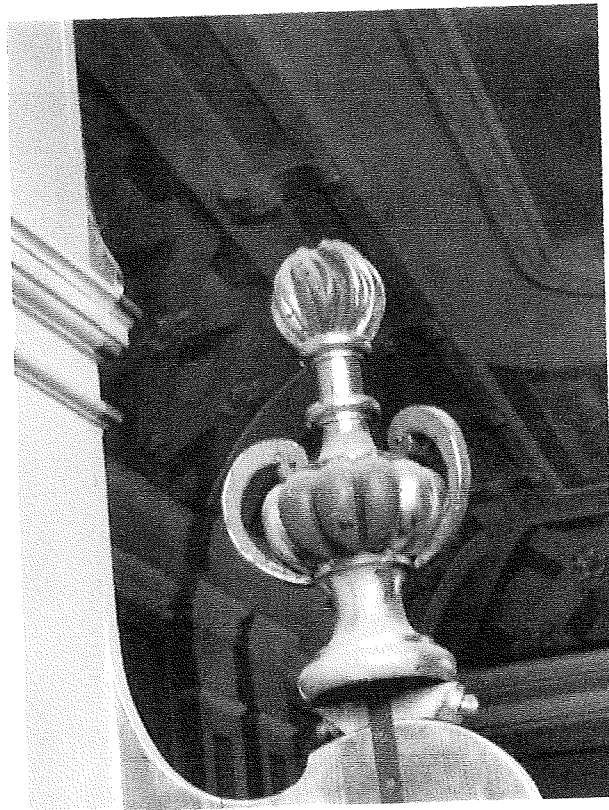
Zniszczenia dekoracji pozłotniczej wykonanej szlagmetalem.
