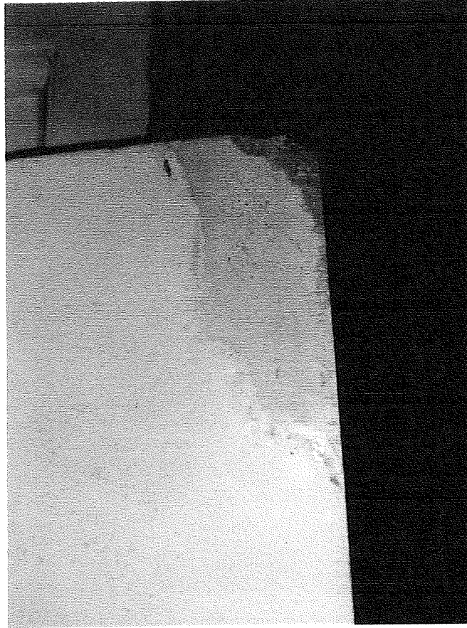
Zniszczenia struktury drewna i powłok malarskich na szafie .
