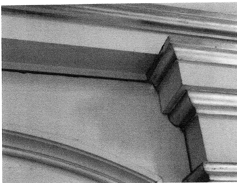
Zniszczenia struktury drewna i powłok malarskich na szafie .
